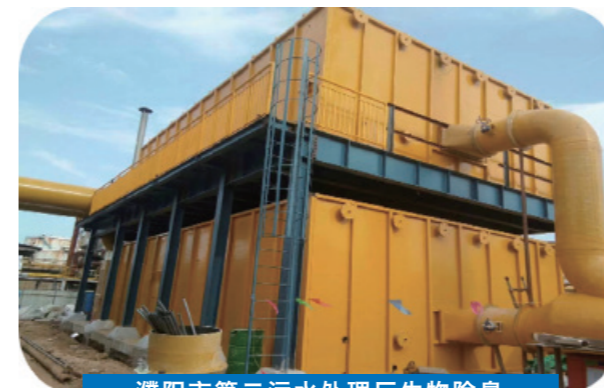
濮阳市第二污水处理厂生物除臭
